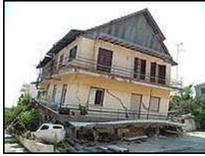
Κατοικία στη χώρα της Λευκάδας που επλήγη από το σεισμό των 6,4 Ρίχτερ τον Αύγουστο του 2003.
