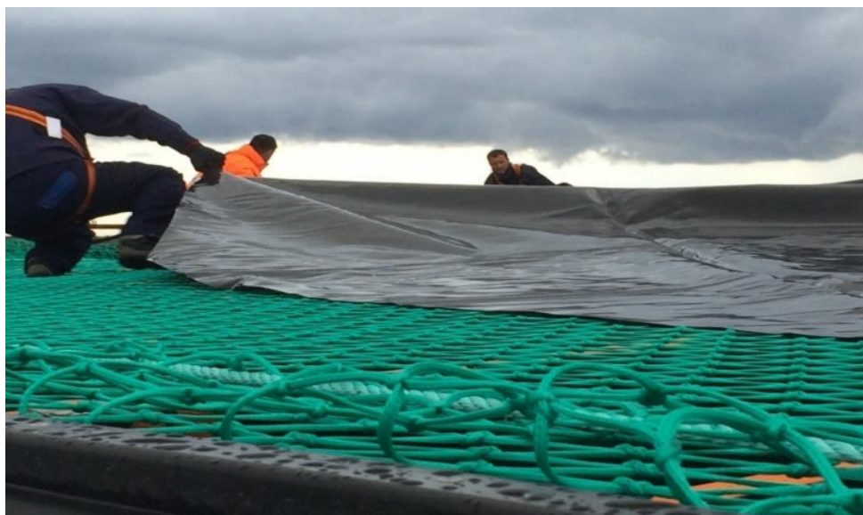
Εικόνα 25 : Δίκτυο αποθείωσης (ενδεικτική φωτογραφία)
