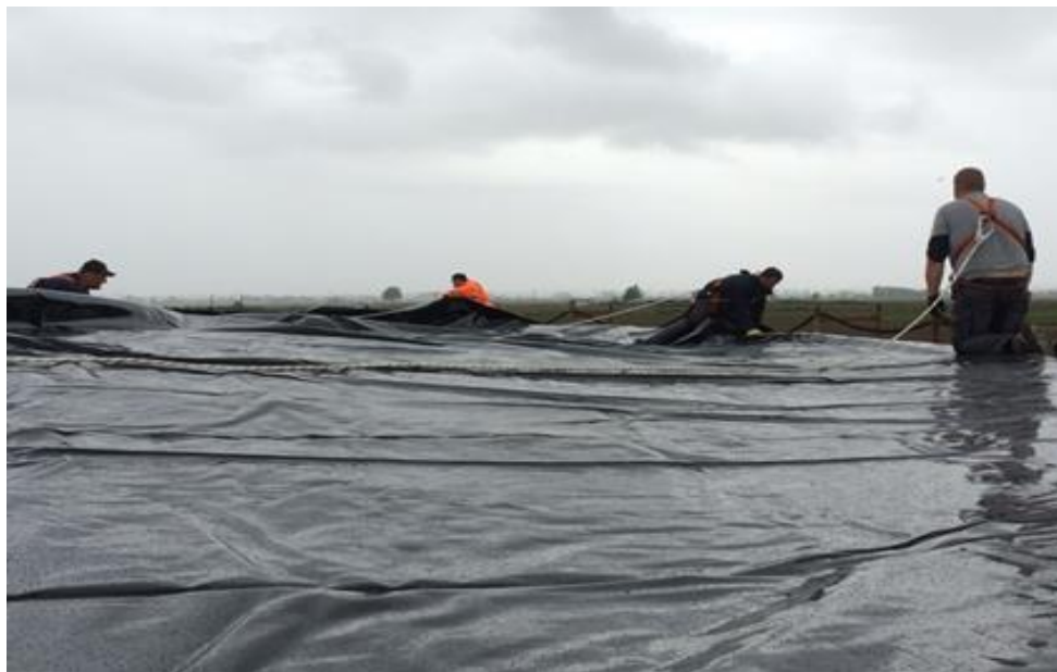
Εικόνα 23: Κάτω μεμβράνη PE υψηλής ελαστικότητας αποθήκευσης παραγόμενου βιοαερίου (ενδεικτική φωτογραφία)
