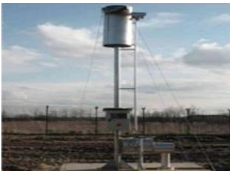
Εικόνα 30 : Ενδεικτική εικόνα πυρσού καύσης
